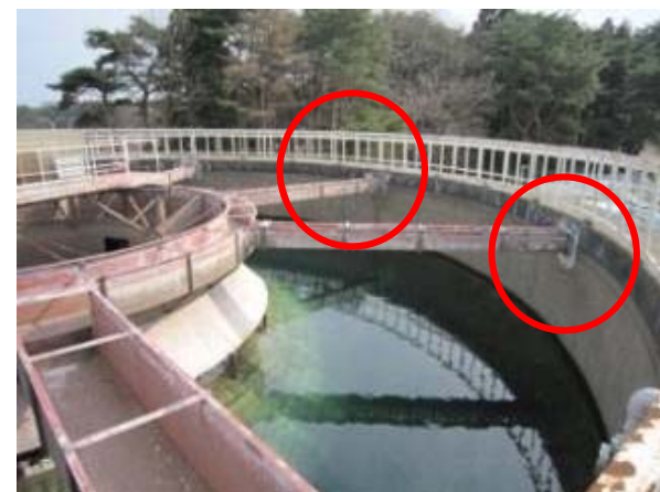
浄水場の固定治具一部損傷の状況
