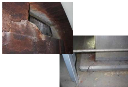
ボイラ内側の耐火煉瓦の剥離 ボイラ土台の割れ
