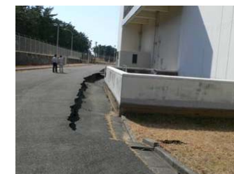
NUCEF周辺に生じた地盤陥没の状況
