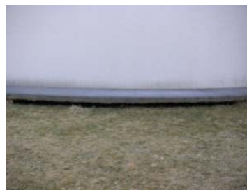
原子炉建家廻りの地盤陥没の状況
