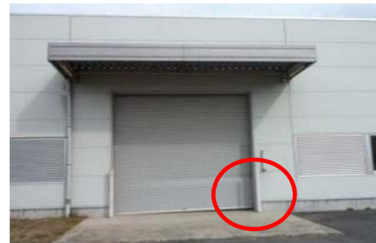
放射性廃棄物保管施設附属建家入口 シャッターの破損 (7月21日復旧済)
