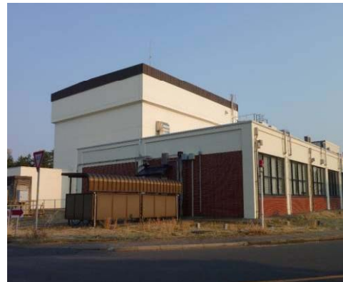
被災度判定調査を実施 (原子炉建家:小破*)
