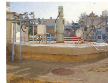
純水製造装置廻りの地盤陥没の状況
