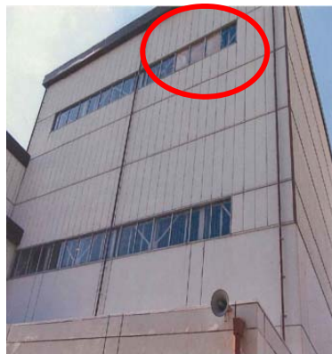
被災度判定調査を実施 (管理棟:小破*)
