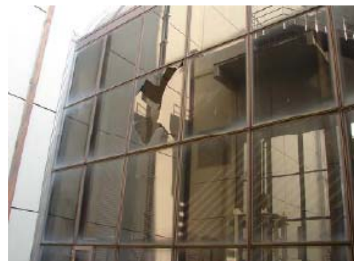
ローディング室北側ガラス破損
