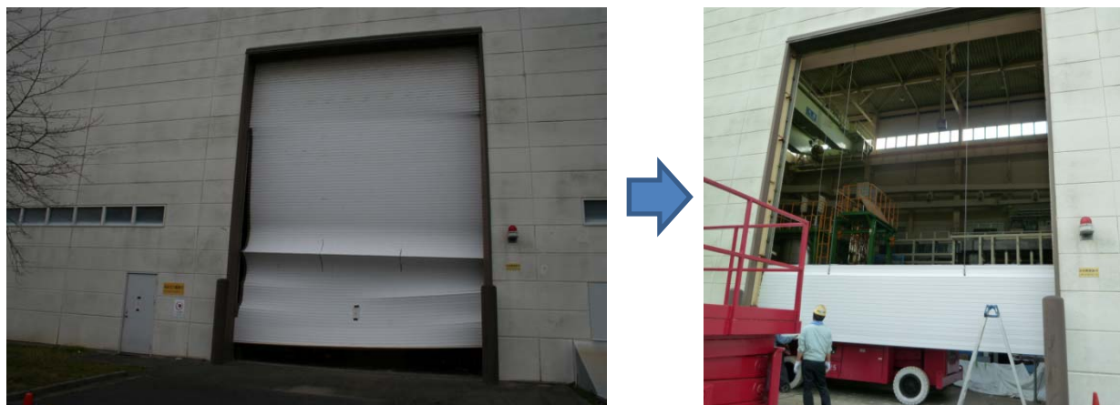
シャッターの破損
