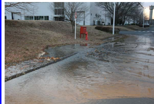
消火栓水漏れ
